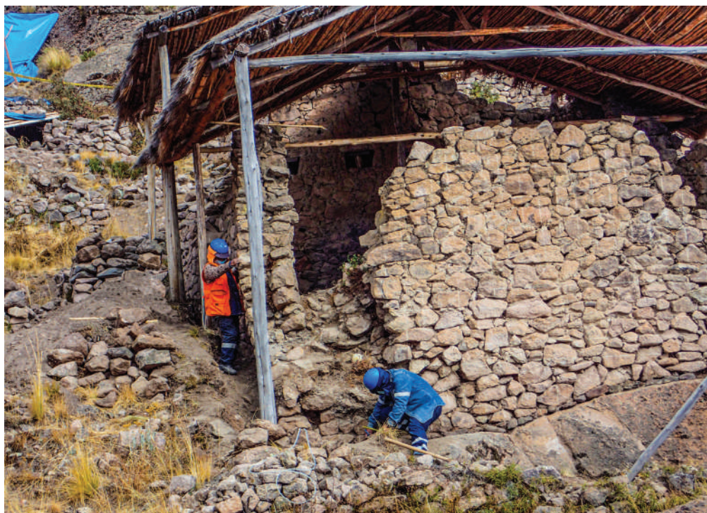
Imagen 4. La imagen detalla el recinto con segmentos de muro colapsado. Foto del Expediente Técnico del año 2019
