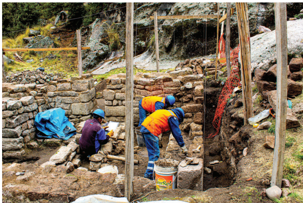
Imagen 12. Trabajos de consolidación, notese el registro grafico que posee el personal obrero, como guía para ubicar los elementos líticos a su lugar exacto en el muro. Fotografía realizada por Emerson Pereyra
