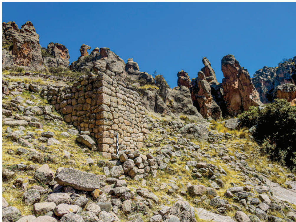
Imagen 3. Detalle del estado de las estructuras arquitectónicas antes de su intervención. Foto de Expediente Técnico del año 2019
