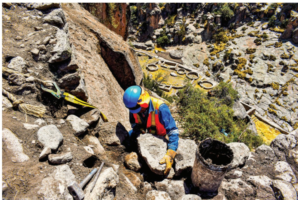
Imagen 13. Trabajos de restitución, realizados en muros de contención en farallones. Fotografía realizada por Emerson Pereyra
